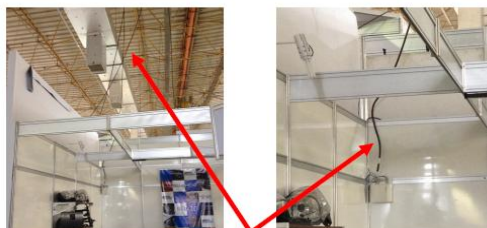
Cabo fornecido pelo EXPO Center Norte.
